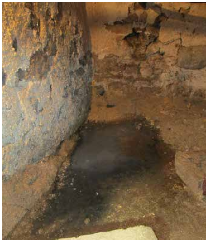
Photo d'une cave dans un état de dégradation avancé suite à l'absence d'entretien par le propriétaire privé, prise lors d'un contrôle de conformité.
